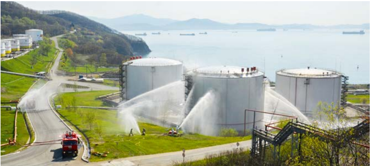
Проведение учений на резервуарном парке, ООО «РН-Находканефтепродукт»
