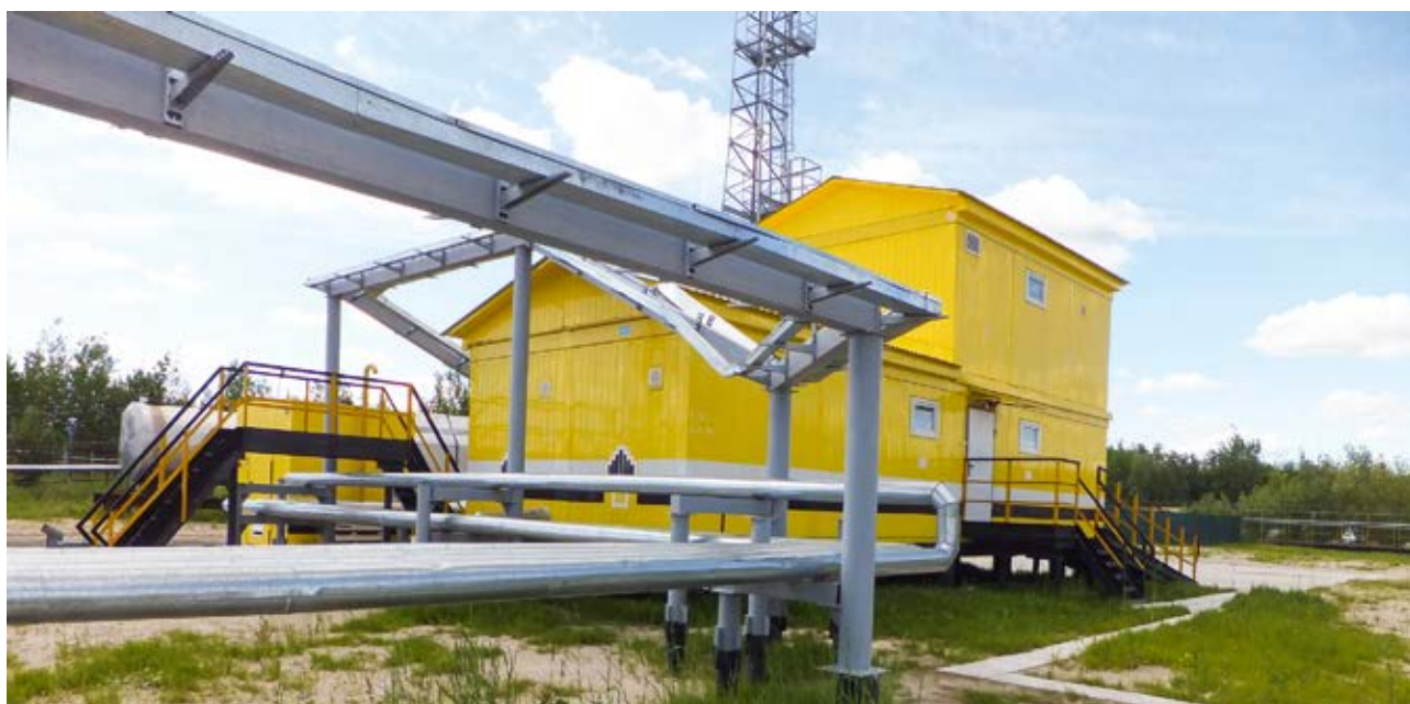
Комплекс для очистки скважин, ООО «РН-Юганскнефтегаз»
